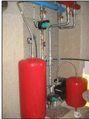
Gestion des réseaux de chaleur
